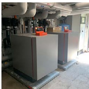
Abb. 52: Wärmepumpen im Keller
