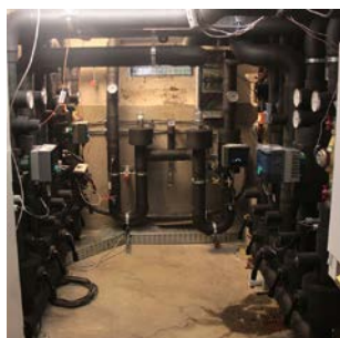
Abb. 53: Hydraulik der Quell-Erschließung im Keller
