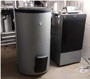
Abb. 37: Speicher und Wärmepumpengerät
