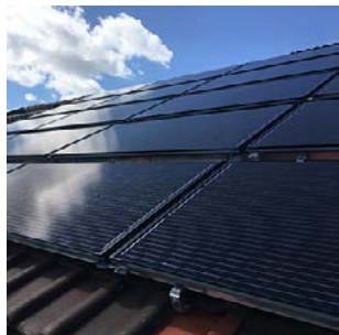
Abb. 58: PVT-Kollektoren auf dem Dach des Gebäudes
