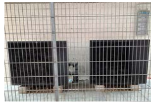
Abb. 67: Zwei Außeneinheiten der Wärmepumpe
